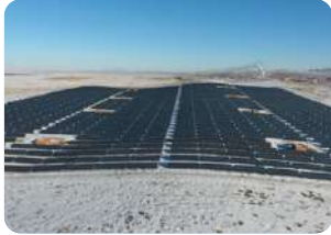
Darkhan-Uul, Mongolia 10 MWdc
