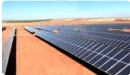
La Solana , Spain 7MWdc
